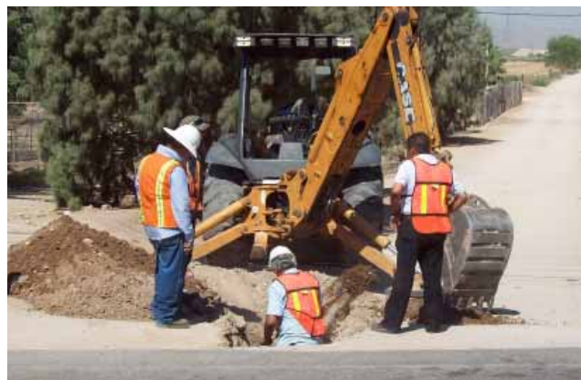
Red de distribución de agua potable, Valle de Mexicali.
