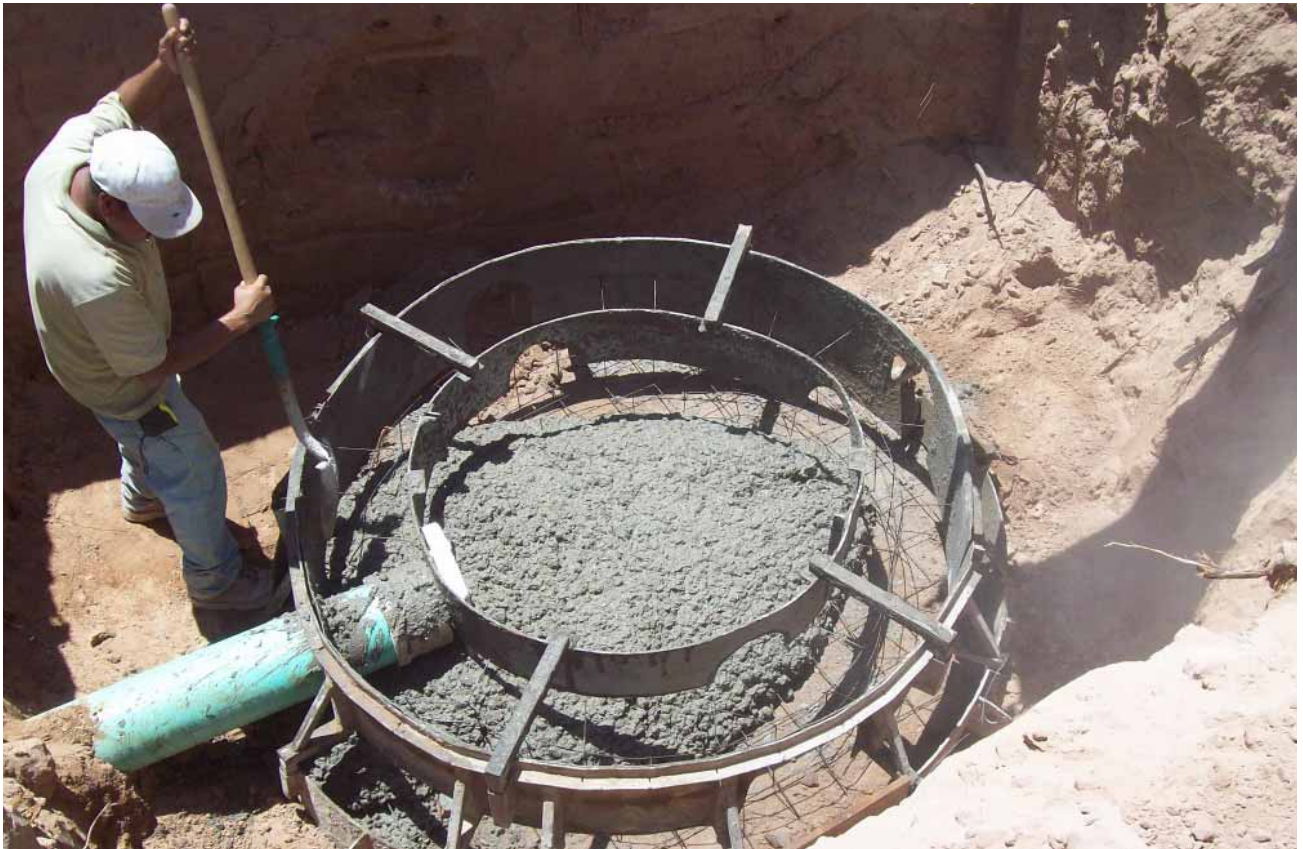
Red de alcantarillado sanitario, en la Colonia Mariano Abasolo, Mexical.
