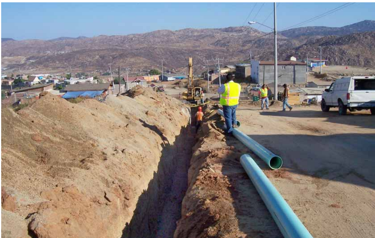
Red de alcantarillado sanitario, en el Fraccionamiento La Sierra, Ensenada.
