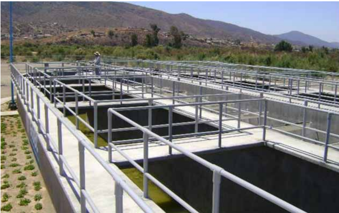
Planta de Tratamiento en Poblado Francisco Zarco, Ensenada.
