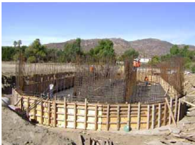
Planta de tratamiento 1, Ensenada.
