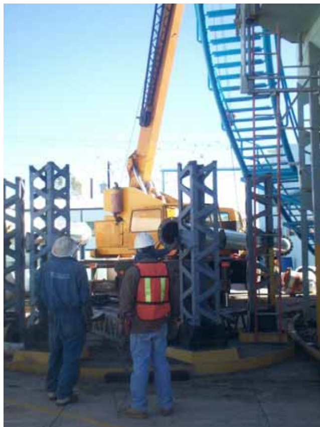
Planta Potabilizadora I, Mexicali.
