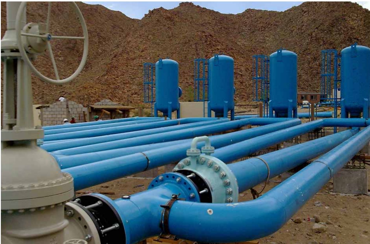
Acueducto Río Colorado-Tijuana
