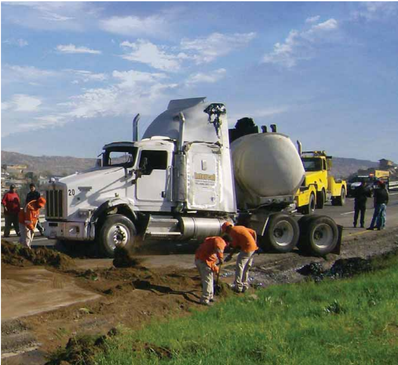
Análisis de riesgo en derrame de combustible, carretera Tecate.
