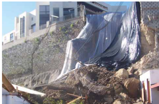
Evaluación de derrumbe en Fracc. Chapultepec de Tijuana.
