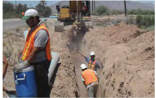
Instalación de la red de agua potable de la colonia Mestizo a Mariana, MXLI
