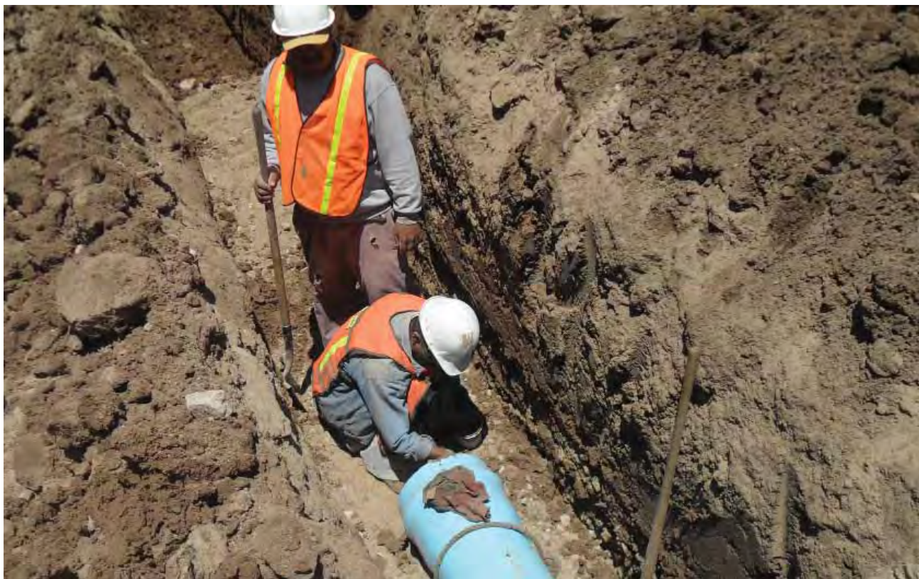
Instalación de la red de agua potable de la colonia Cucapah Mestizo a La Mariana, Valle de Mexicali.
