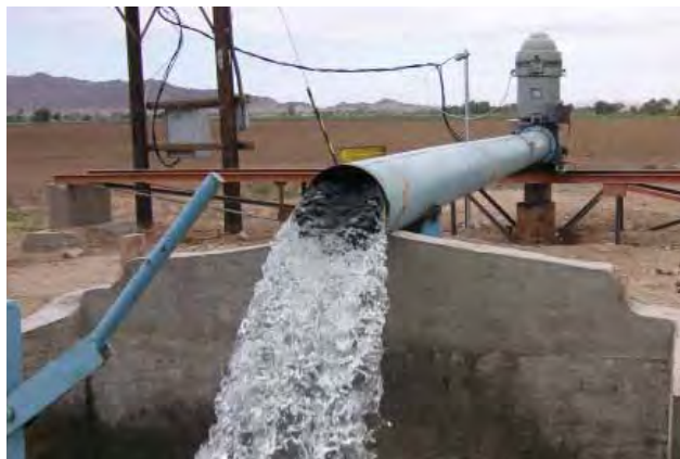
Instalación de medidores volumétricos, Valle de Mexicali.
