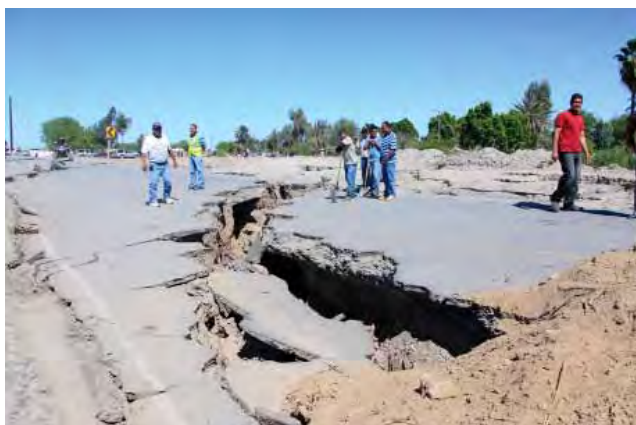
Evaluación de suelo y grietas por el sismo 7.2, Valle de Mexicali.
