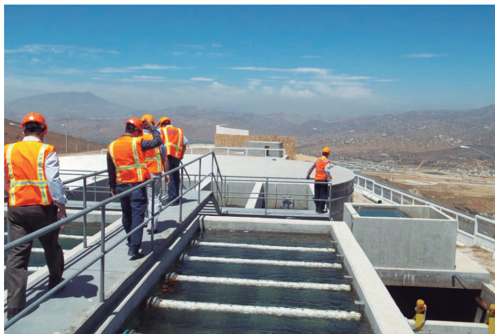
Planta Potabilizadora El Carrizo, Mexicali, B.C.
