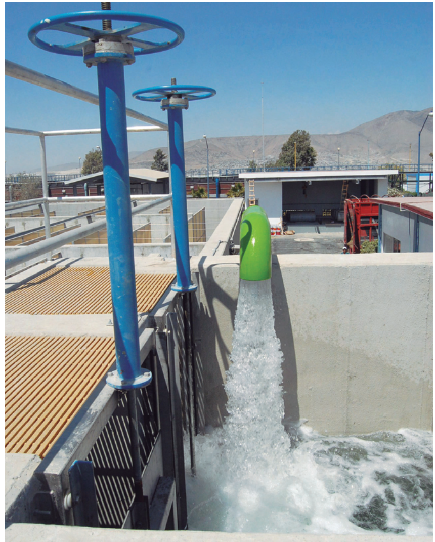
Módulo adicional de producción de agua potable en la Planta Potabilizadora El Florido, Tijuana.
