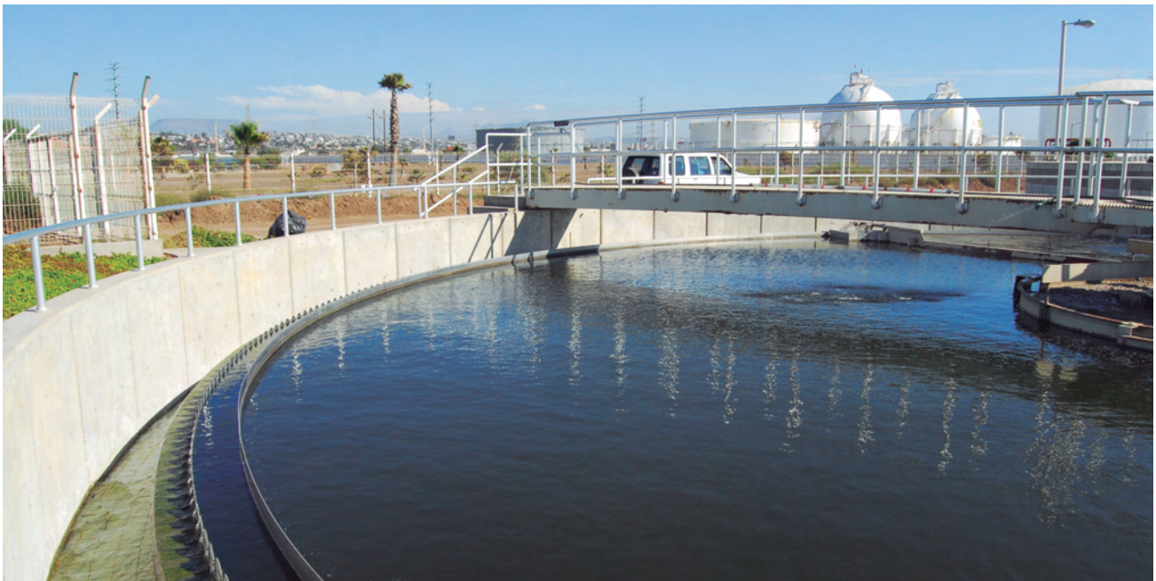
Planta de Tratamiento de Aguas Residuales Rosarito Norte.
