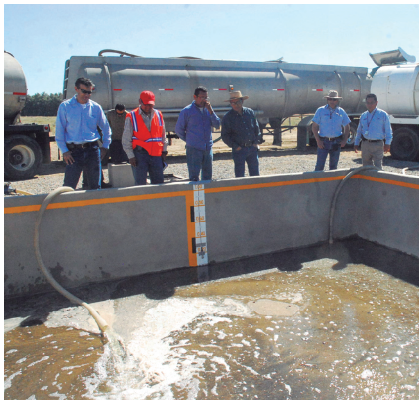
Infiltración de agua tratada al acuífero en Valle de las Palmas.
