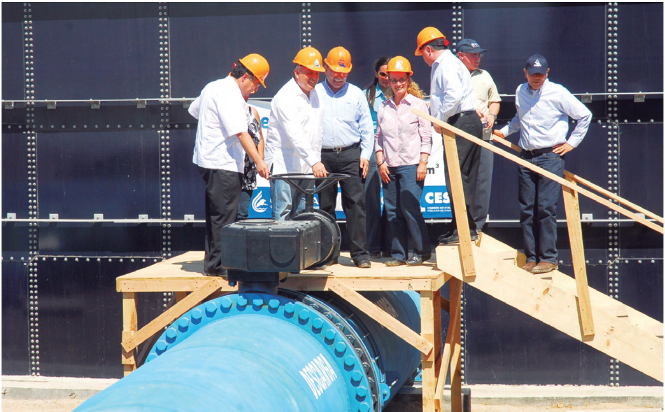
Tanque de reserva para recibir agua adicional del Acueducto Río Colorado, B.C.
