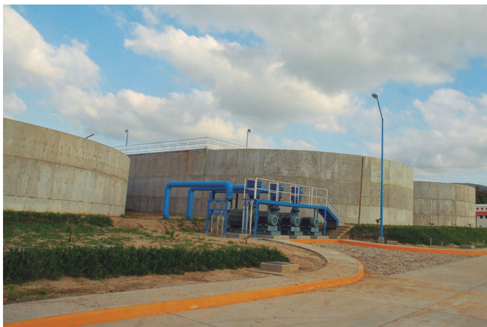
Planta de Tratamiento de Aguas Residuales La Morita 1, Tijuana, B.C.
